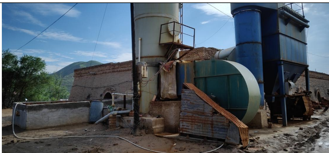
除尘脱硫系统
