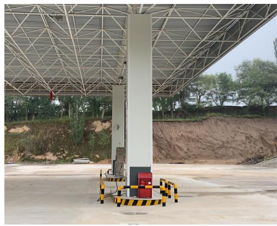
加气区消防设备
