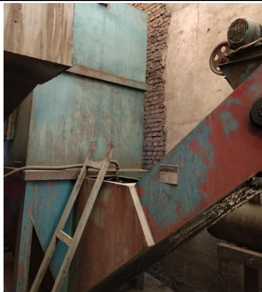
高脱硫冲激式水浴除尘器
