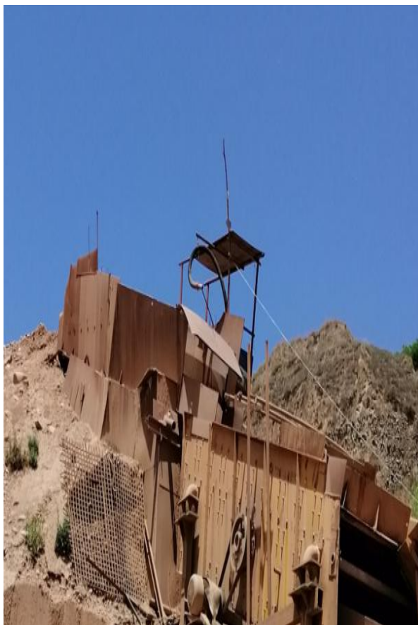
验收时项目洒水降尘水管
