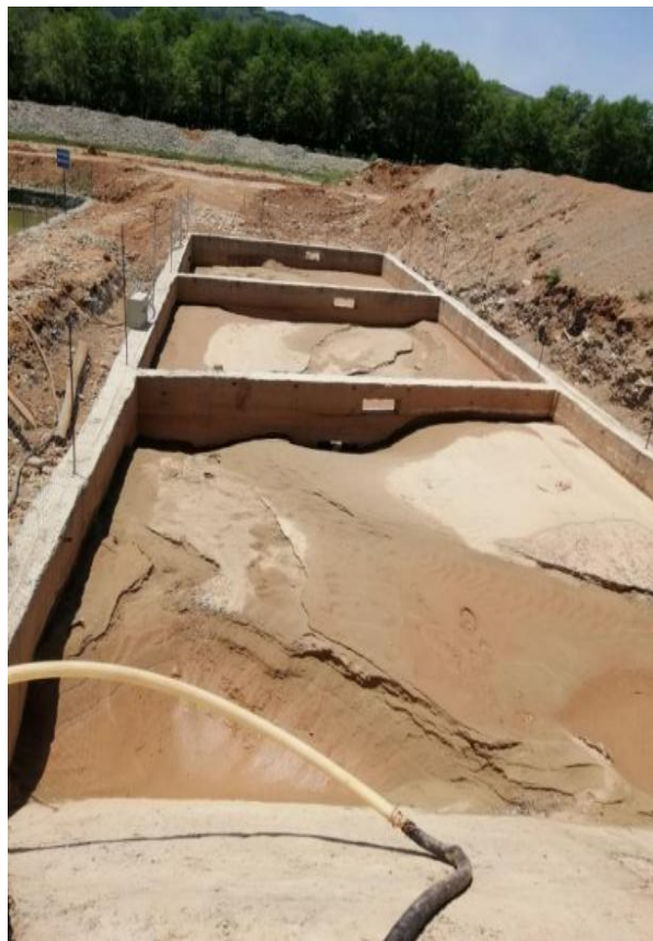
项目三级沉淀池
