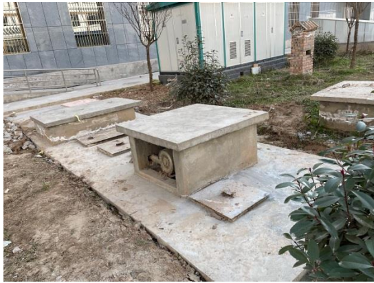
地埋式污水处理站
