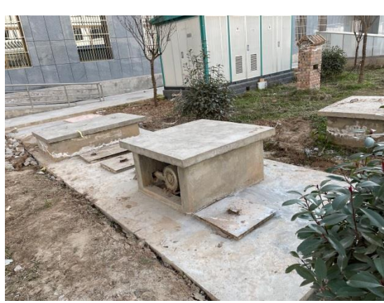
地埋式污水处理站
